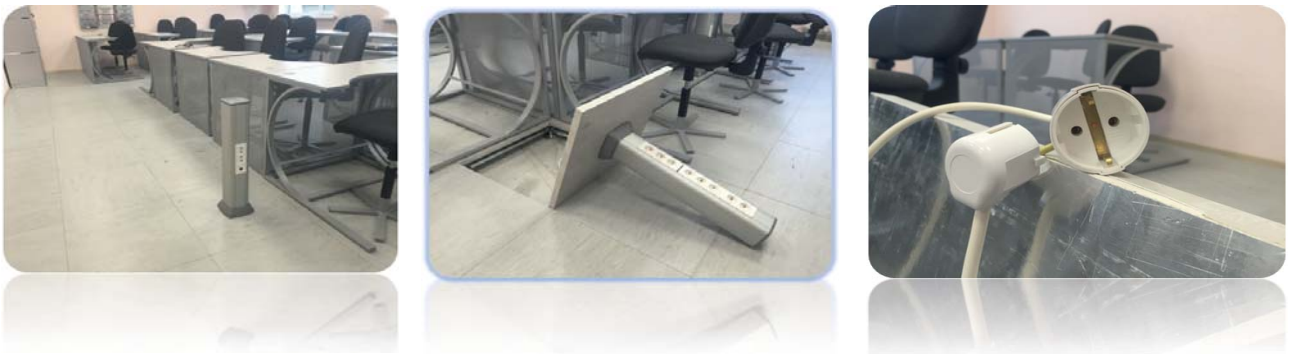
Рис. 2. Мобильные точки подключения к электропитанию, локальной сети аудитории и Интернету
